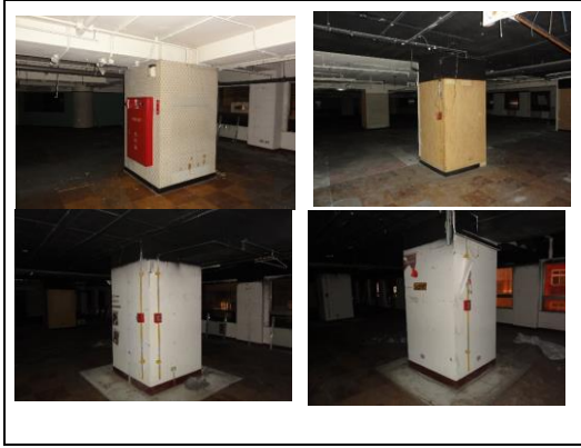
照片3：消防管線中繼與末段設備遮蔽防護
