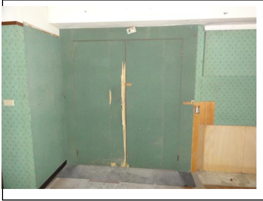
照片1：木作雙開搖擺門拆除(阻礙後逃生門)
