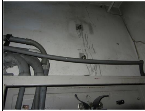
照片2：無110V變壓器規劃設置新品
