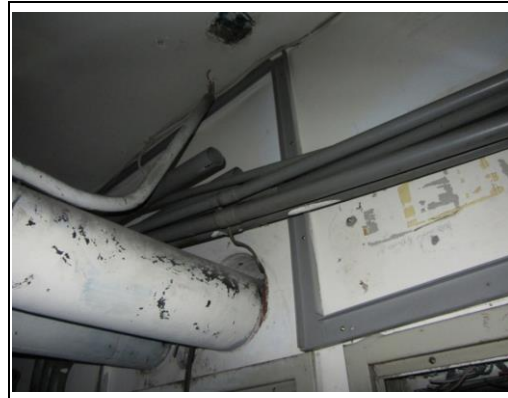
照片6：開關箱上方雜亂整理
