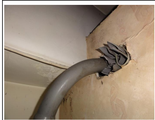
照片2：天花板多處零散之空置及破損電管
