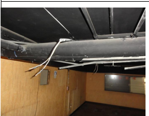
照片3：天花板多處零散之空置及破損電管
