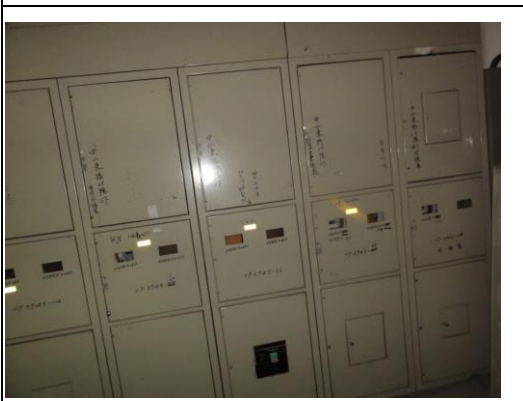
照片7：受電室現各戶電錶箱
